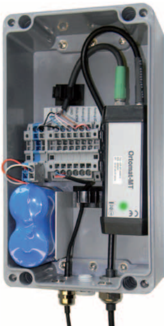
Verteilerbox mit Lithium- Batteriepaket
